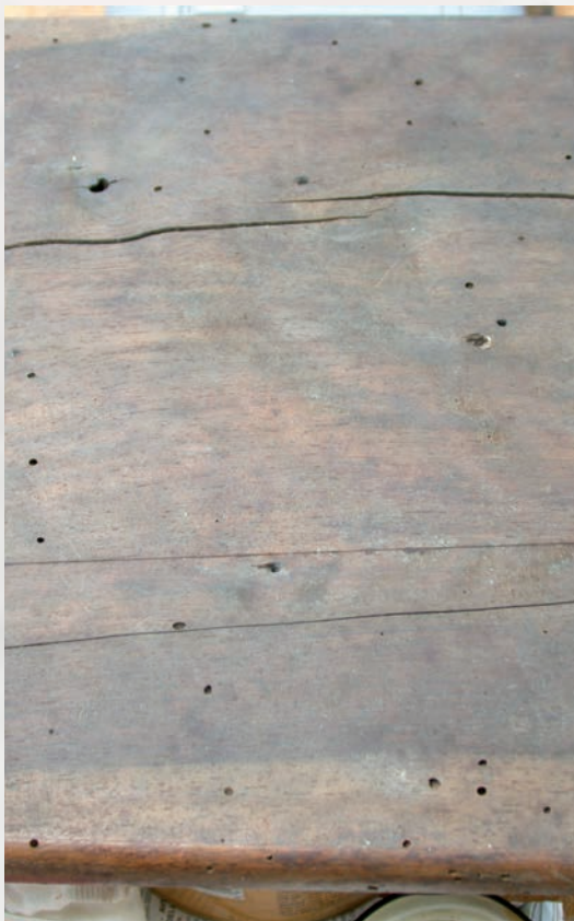
Fissures de la fusta i orificis causats pels insectes
