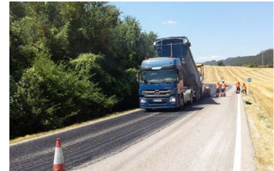
Reparació del paviment amb mescla bituminosa en calent a la carretera TV-2441, de Santa Coloma de Queralt a Pontils.
