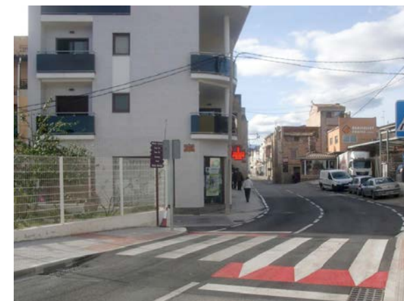
Reductor de velocitat tipus pas de vianants a Benifallet. Carretera T-301.
