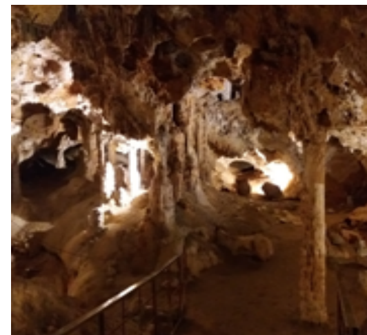
Direcció d'obra de la renovació de l'enllumenat públic i ornamental de les Coves Meravelles i Marigot de Benifallet.
