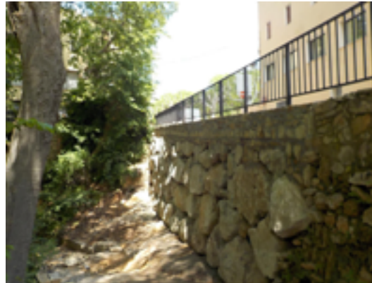
Mur d'escullera i barana de protecció a la carretera TV-2006, PK 1+900, d'Aiguamúrcia a Santes Creus.
