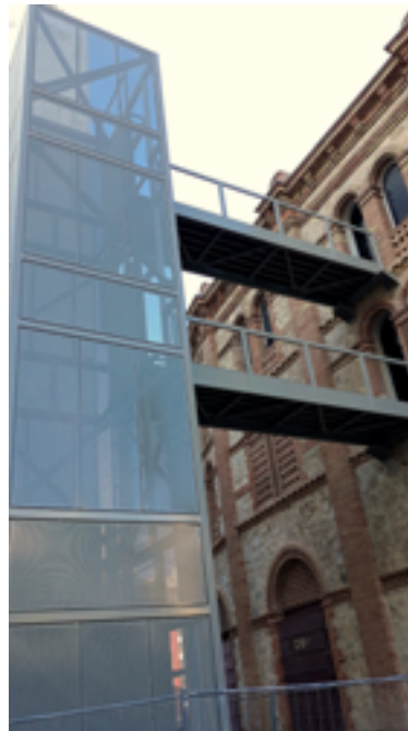
Muntacàrregues exterior de la TAP.
