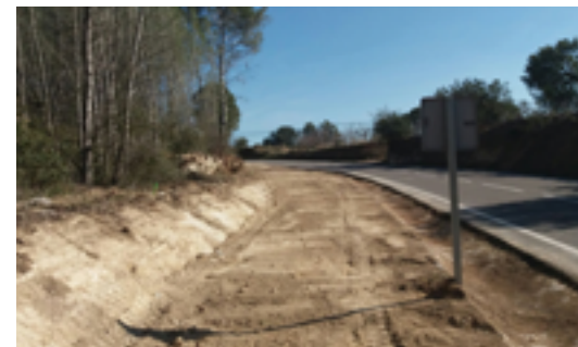
Millora de la seguretat a l'accés a la urbanització Mas Fontana, del PK 1+500 al PK 1+650 de la T-751.
