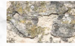
Separació de plaques i pèrdues de suport
