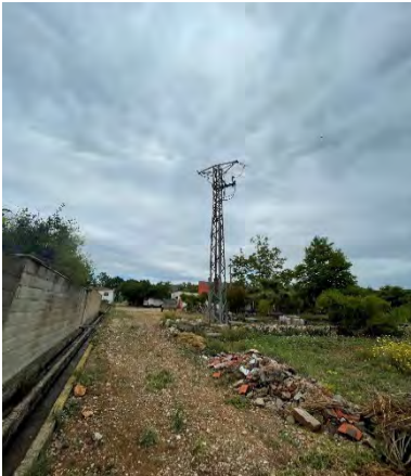
Imatge 28. Torre de mitja tensió al PK 0+143,86 .
