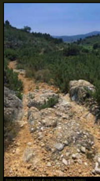
Vials excavats a la pedra viva a Camí de Sant Joan de Vilatorrada.
