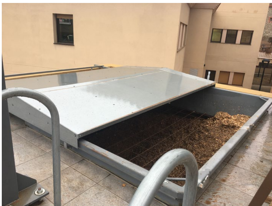
Caldera de biomassa.
