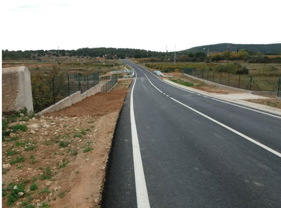
Condicionament de la carretera TV-2021, de Vespella de Gaià a la Nou de Gaià.
