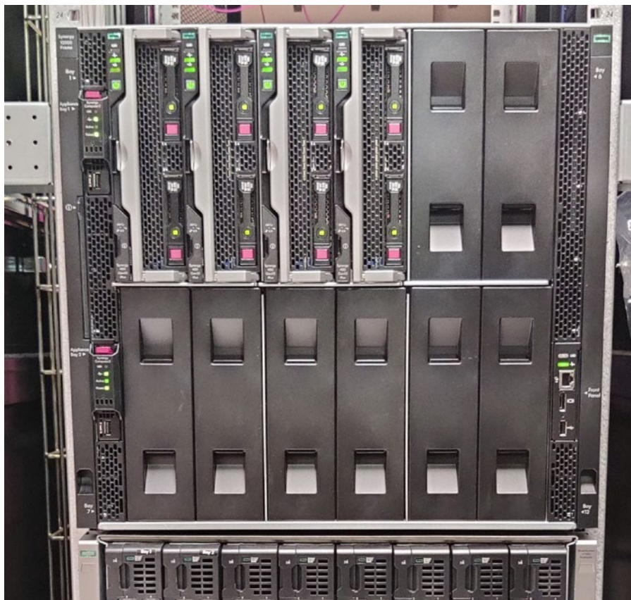
Infraestructura de computació al CPD de Palau.
