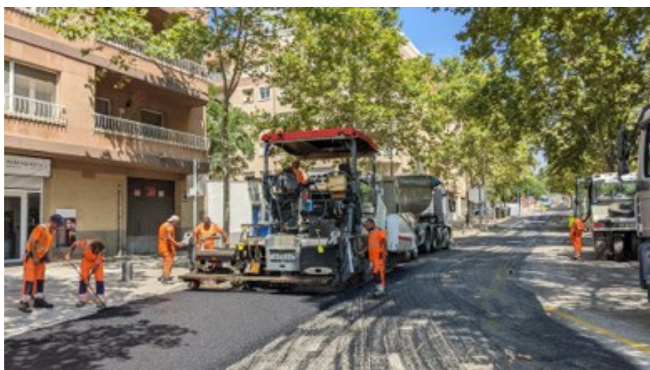
Reforç de ferm a la carretera TP-7049, de Reus a Castellvell del Camp.
