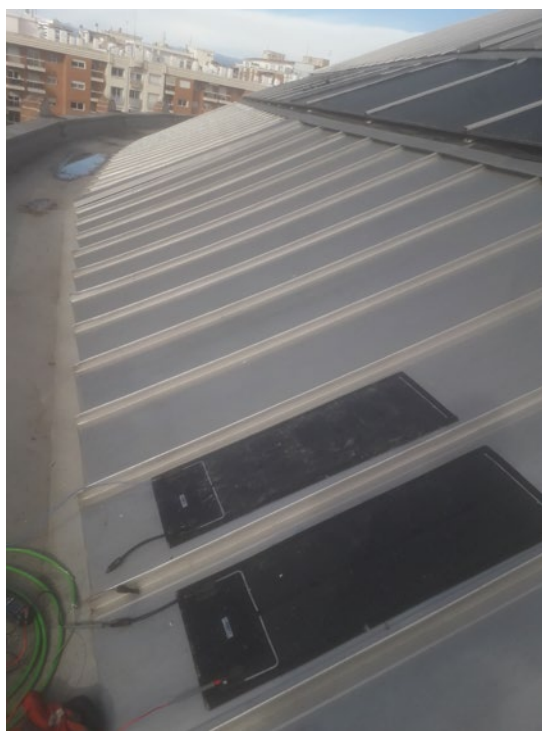
Plaques solars flexibles, com a prova de la futura instal·lació de plaques solars a la coberta de la Tàrraco Arena.
