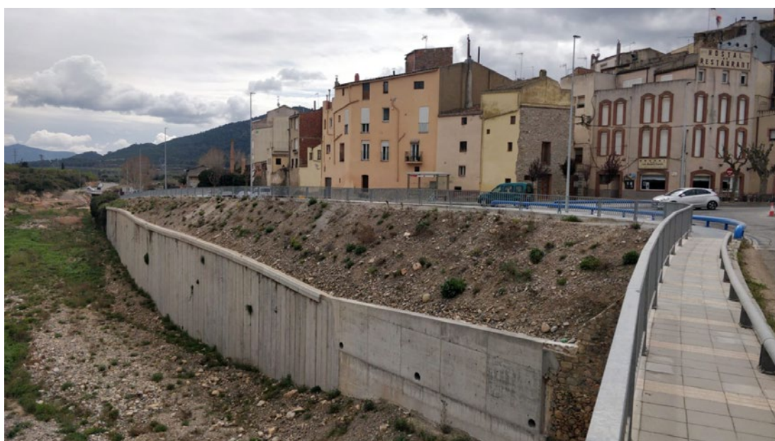
Reparació del mur de contenció ensulsiat, talussos de la carretera i vorera malmesa a la carretera TV-7001, a l'Espluga de Francolí.
