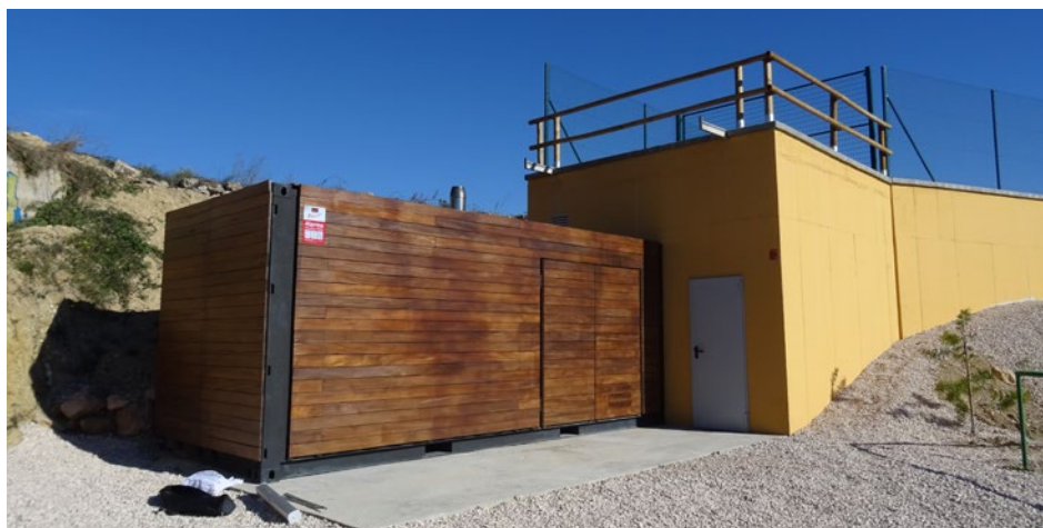
Caldera de la xarxa de calor de proximitat del Montmell.
