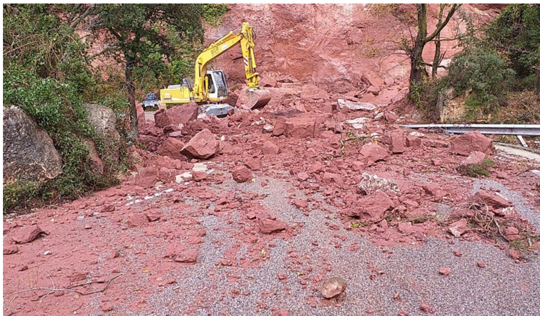
Esllavissada al pk 3+225 de la carretera T-3225.
