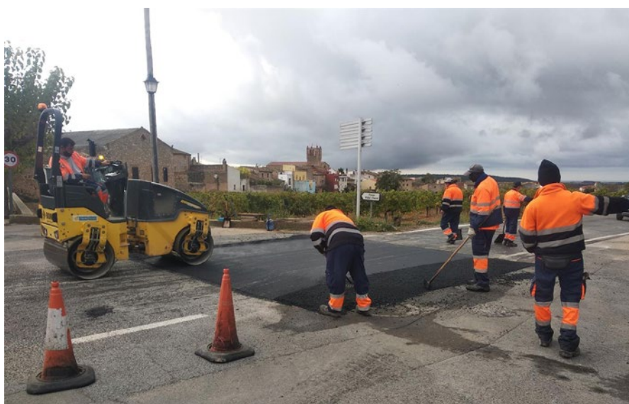
Millores puntuals de seguretat i drenatge a la carretera TV-2441, a les Pobles.
