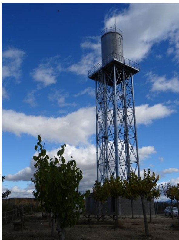
Dipòsit d'abastament d'aigua potable a Vilabella.
