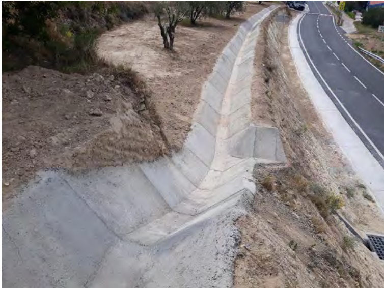
Construcció d'una cuneta de guarda a la carretera TV-2021, PK 2+000, de Vespella a la Nou de Gaia.
