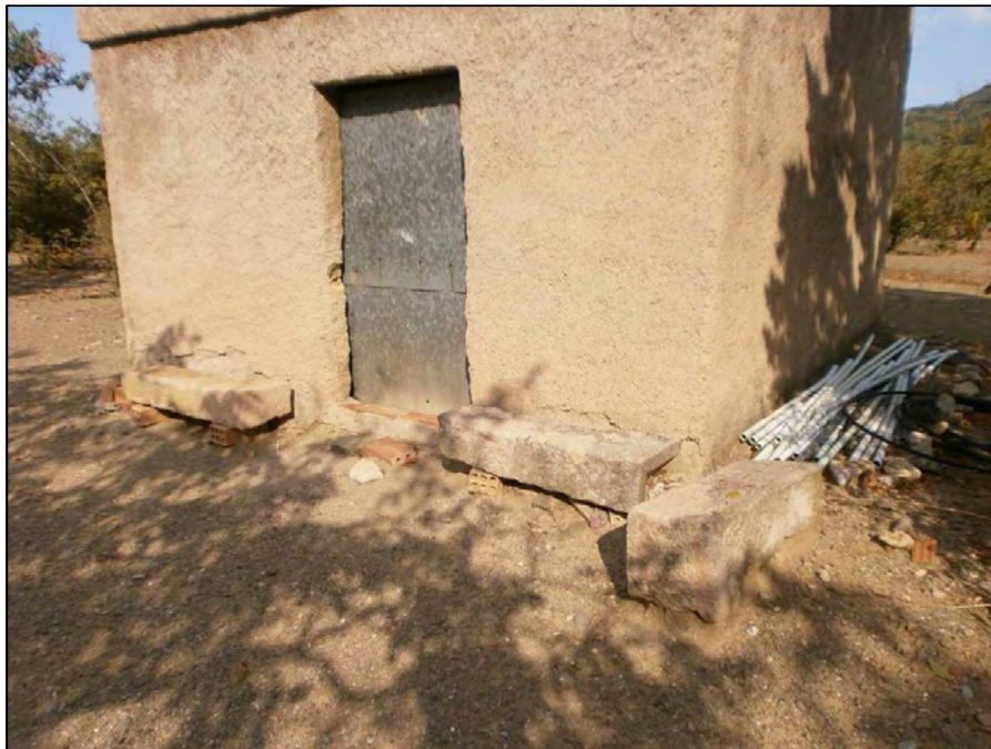
27.- Detall de la CASETA 2, amb detall dels carreus presents en el seu exterior.
